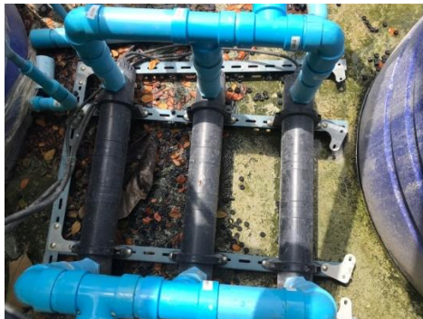
ภาพที่ 8 ระบบฆ่าเชื้อ (Ultraviolet Filter)
