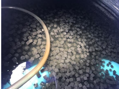
ภาพที่ 7 ถังบำบัดแอมโมเนีย 2 (fixed-bed bioreactor tank)
